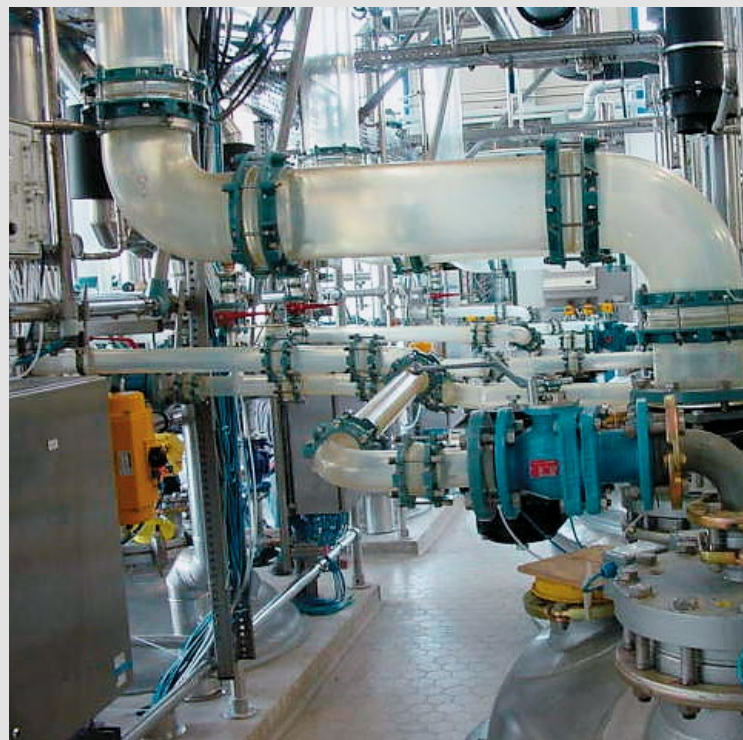
DN300 vapor line with protective glass coating DN300 Brüdenleitung mit Schutzbeschichtung
